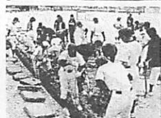
重い土を敷き、溝の間に落ちた砂を取り除き、深い溝から出て重い砂をスコップで上げます。腰が痛くなる作業、一苦労の様子でした。
